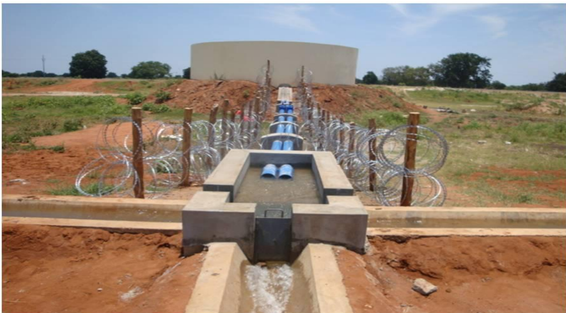
Figura 9: Sistema de rega instalado na VMC
